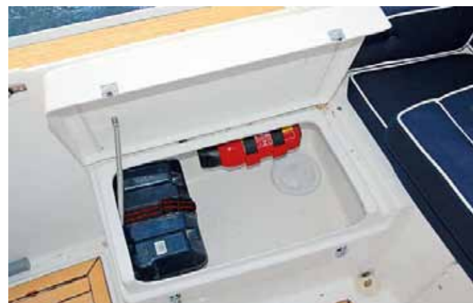
Im Inneren der steuerbordseitigen Verlängerung der Heckbank wurden ein Handfeuerlöscher und die Starterbatterie installiert
