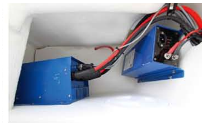
LANDSTRØM: Etter fem timer ladning er batteribanken full og båten er klar for ny tur med el-drift.
